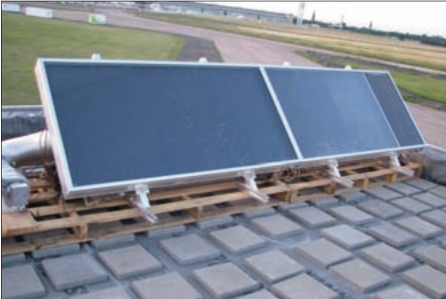
Bild 2: Die Solarluftkollektoren auf dem Dach des Versuchsgebäudes
