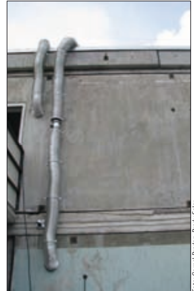
Bild 3: Durch die Alu-Flexröhren strömt Frischluft in das Versuchsgebäude
